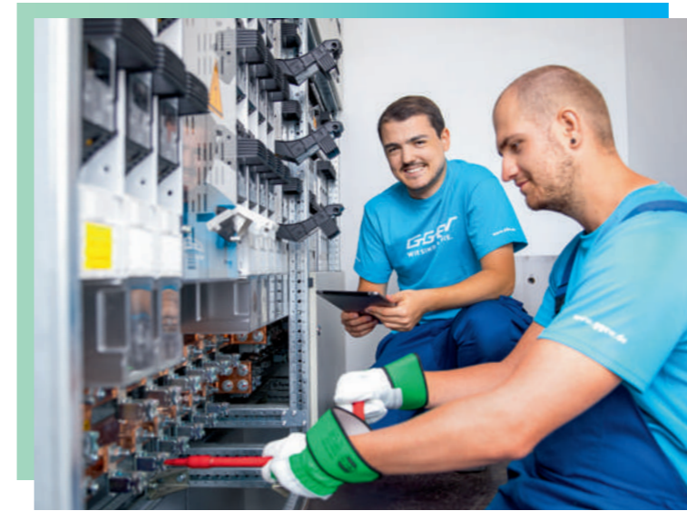
Die Versorgungssicherheit mit Strom, Gas und Wasser ist unser oberstes Ziel
